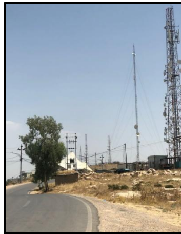
الصورة رقم (9) الصورة توضح الابراج واجهزة الاتصالات في منطقة الدراسة
